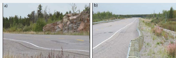
FIGURE 4 : Photographies de l'autoroute 3 illustrant a) la subsidence différentielle du revêtement et b) le déplacement de la glissière de sécurité provoqué par le glissement rotationnel des pentes latérales du remblai (Stevens et al. , 2012).
