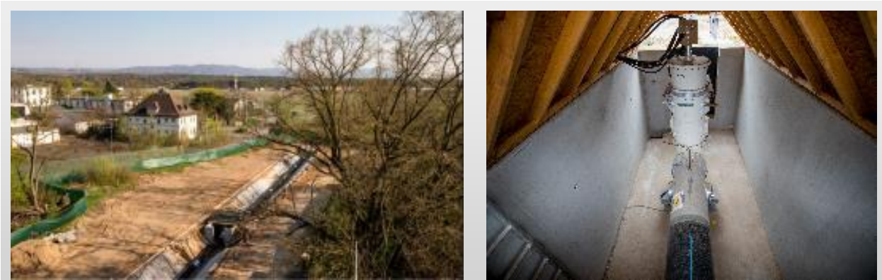
Figure 10 : Ligne pilote (phase de construction) pour les essais thermiques et mécaniques; droit d'auteur Siemens 39
