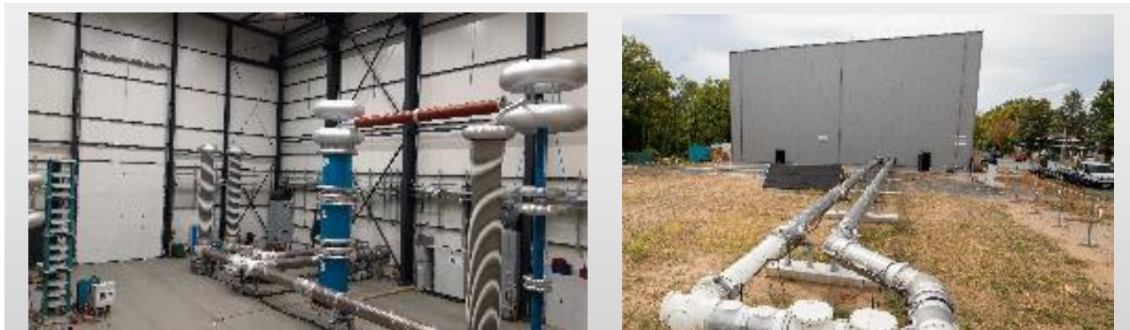
Figure 9 : Installation d'essai pour la vérification à long terme de la ligne à isolation gazeuse à courant continu à Darmstadt (à gauche : alimentation en tension et en courant; à droite : dispositif d'essai électrique); droit d'auteur Siemens AG, voir également 38
