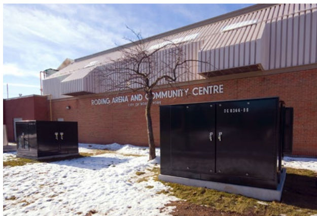
Projet eCAMION de 500kW/250kWh de stockage d'énergie dans une communauté avec Toronto Hydro
