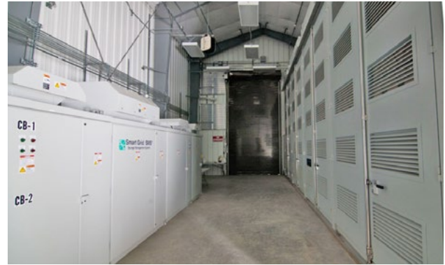
Équipements de contrôle de la batterie de BC Hydro à la sous-station de Field
